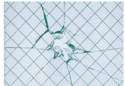
■網入板ガラスの破壊形状
